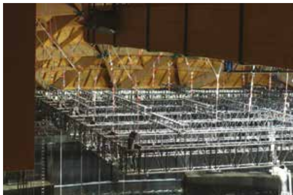
Alcune immagini del sistema informatizzato di pesatura dei carichi sospesi installato da Molpass all'Unipol Arena
